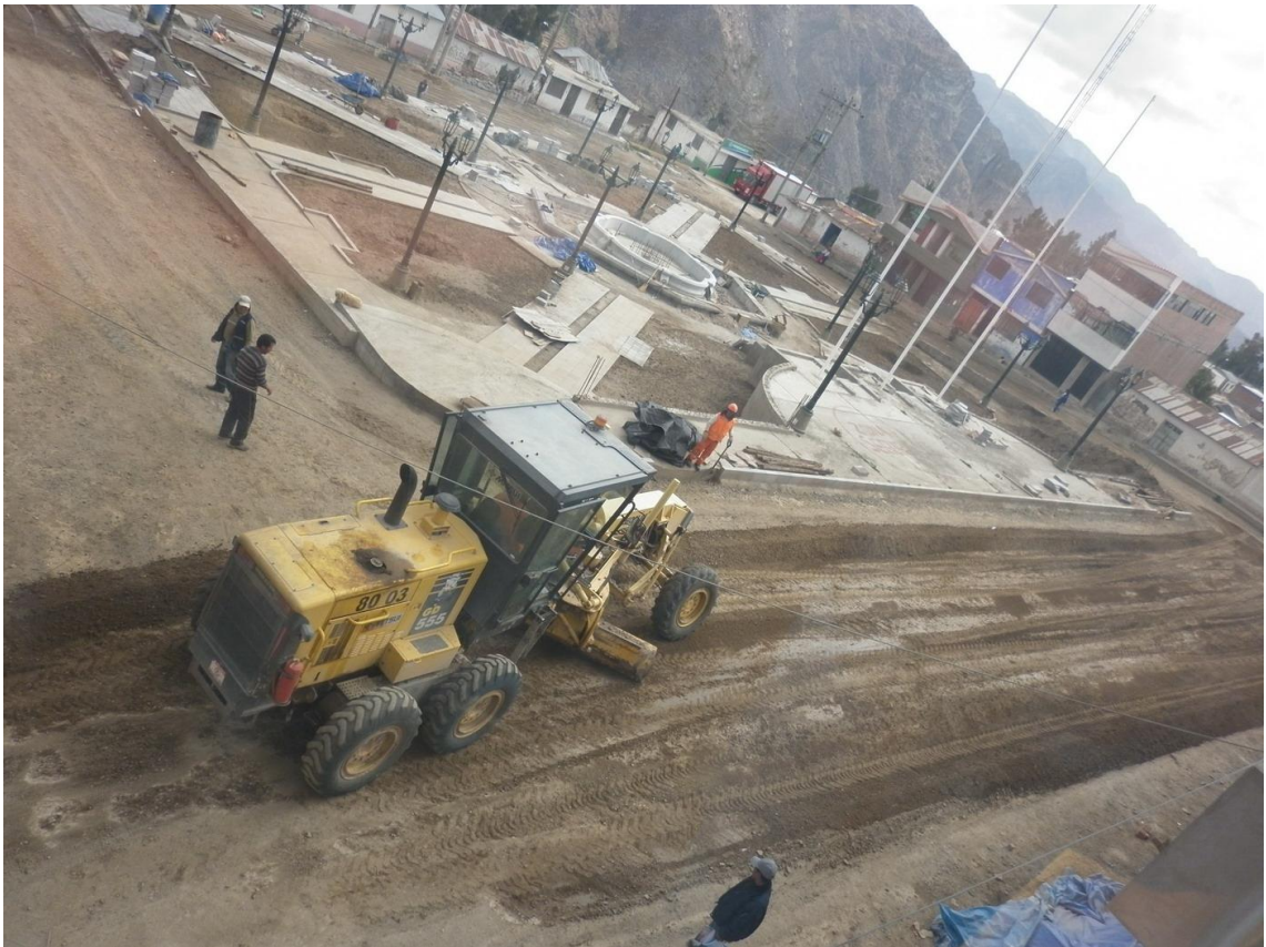
1 Obras en la plaza de Calacoa, vista desde el hotel recién construido
